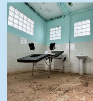
2024年9月の洪水で泥水が流れ込んだサブセンター内部の分娩室
